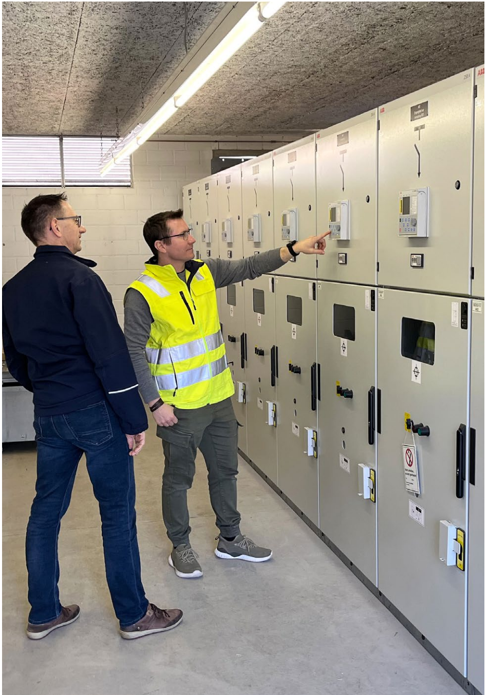
Patrick Schönenberger und Roger Baumgartner in der neuen Trafostation St. Josef.
