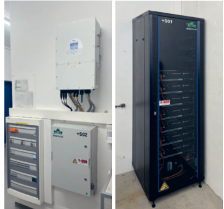
Notstromanlage und Batteriespeicher der EWU AG im Stadtgraben.
