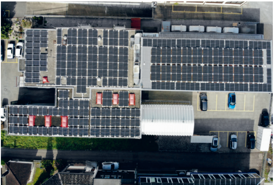
Drohnenaufnahme der Photovoltaik-Anlage auf dem Dach der Hilty Engineering AG
