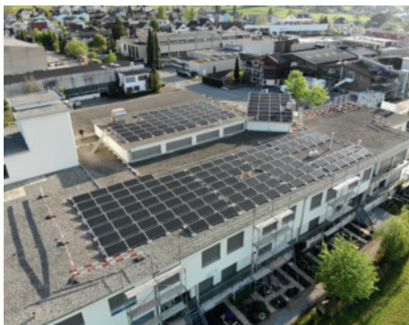
PV-Anlage versorgt das Haus der Edelsteine in Uznach.
