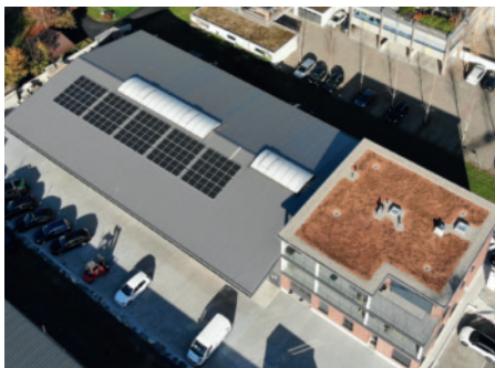
100. PV-Anlage auf dem Werkhofdach der B. Bachmann Bau GmbH.
